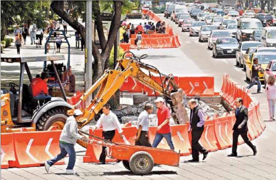
Las obras de la línea 7 del Metrobús en Paseo de la Reforma han ocasionado severos problemas viales. La imagen fue tomada ayer desde el Ángel de la Independencia ■ Foto María Luisa Severiano
